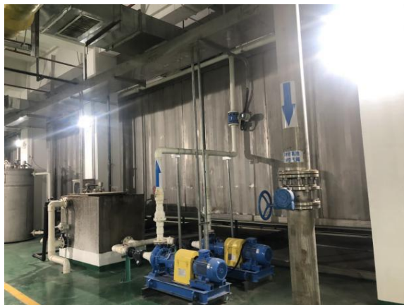
生物除臭装置
